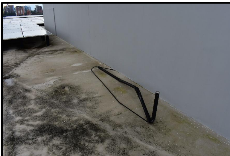
Fotografía No. 12 Vista de la parte de la baranda separada durante el impacto.
