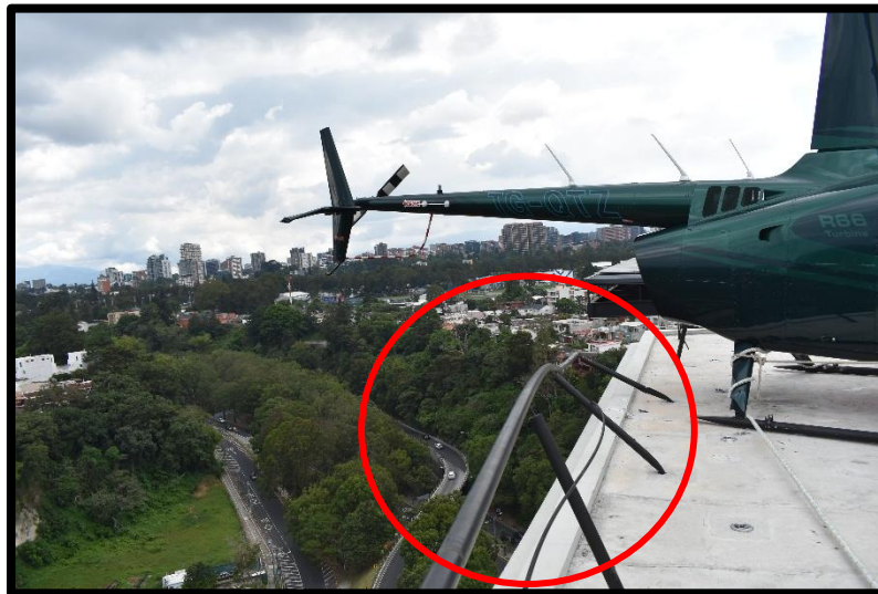
Fotografía No. 8 Vista de la baranda perimetral de seguridad con daños.
